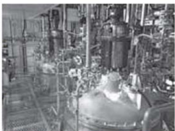
感光材第3工場の増強ラインは4月に稼働した（写真は反応設備）
