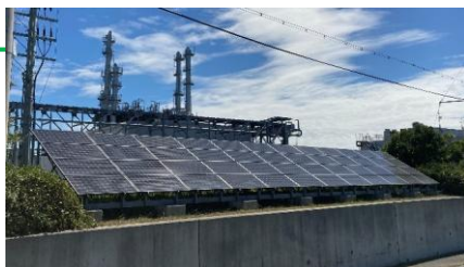
淡路工場の 太陽光パネル
