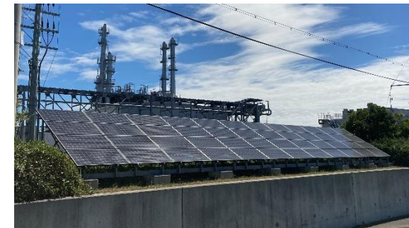
淡路工場のグリーン電力（太陽光パネル）設備
