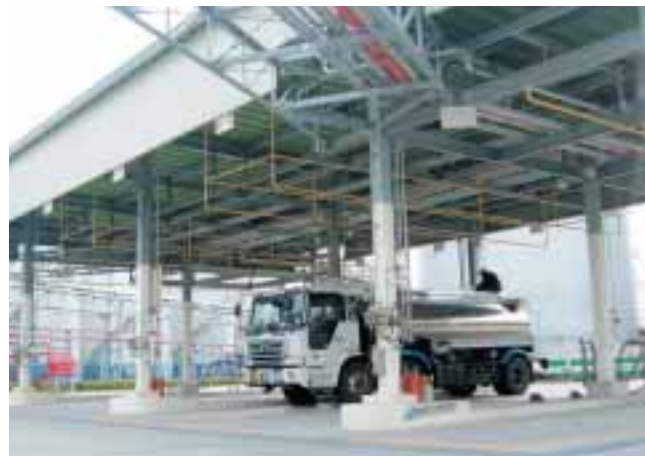
ローリー充填所落下防止安全バー
