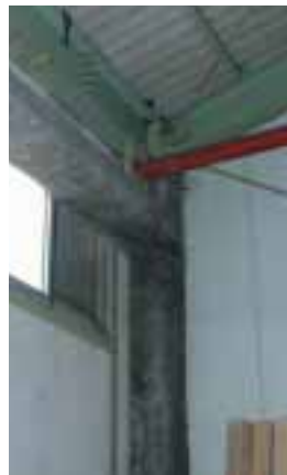
吹き付けアスベスト
